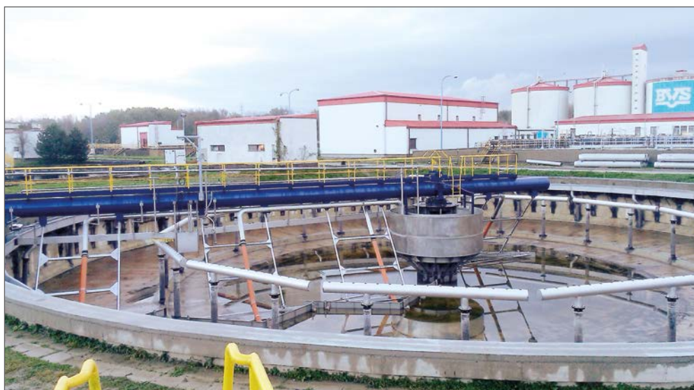
Dosazovací nádrže slouží k zajištění sedimentace kalu, jeho transportu, odstranění plovoucích nečistot z hladiny a odvodu vyčištěné vody
